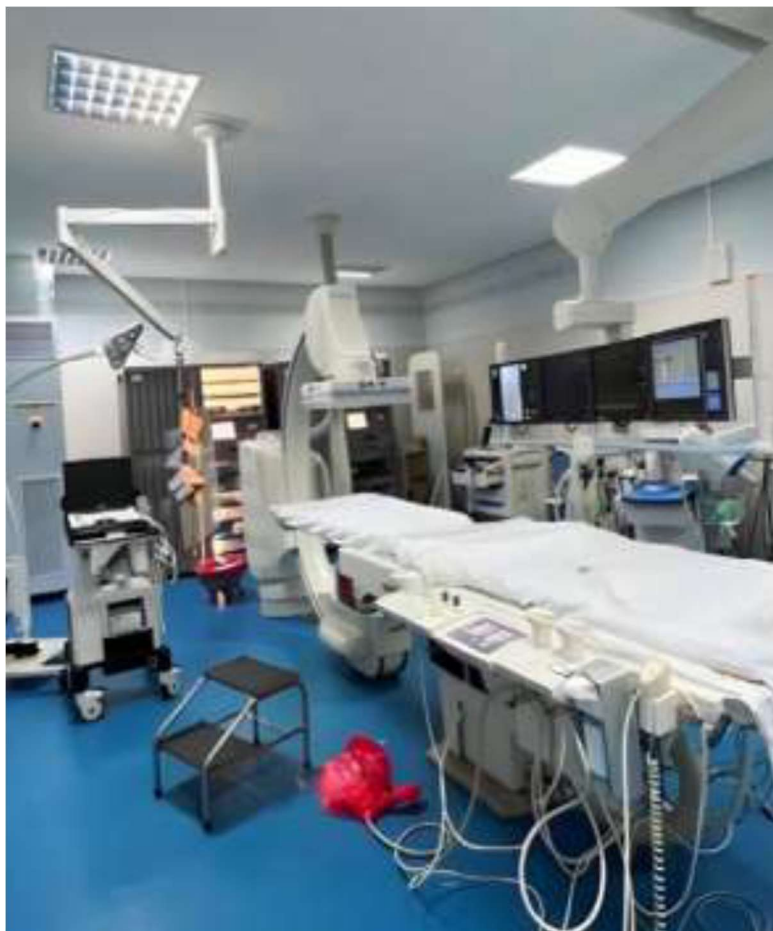
Figure N° 1 : Salle d'angiographie du service de radiologie de l'Hôpital Arrazi(8)
