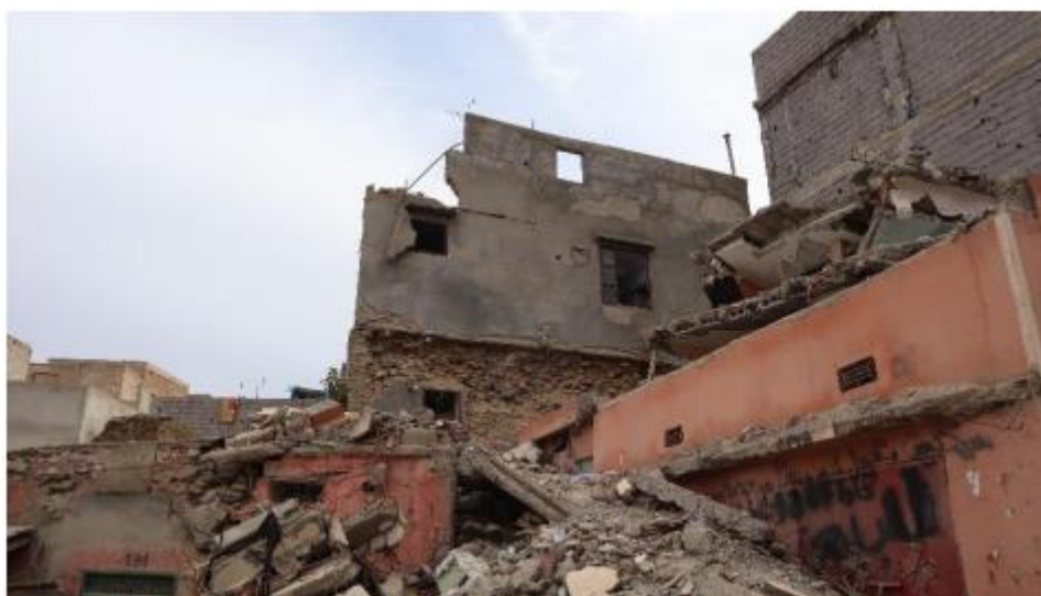
Figure 38: Photographies illustrant l'ampleur des dégâts causés par le séisme dans la ville d'Amizmiz. Crédit photo : M. Beqiraj[27]
