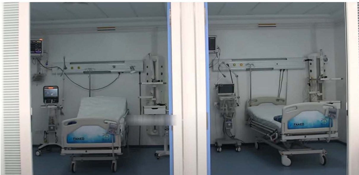
Figure 53,54 : Unité de réanimation du CHP d'Essaouira
